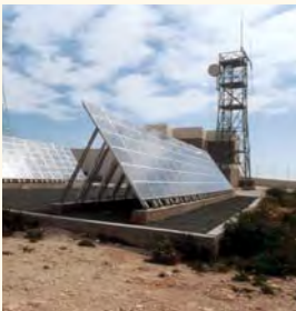
Sous-station de téléphonie mobile fonctionnant à l'énergie solaire.
